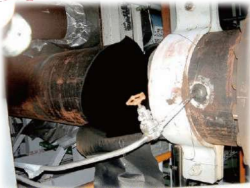
事故のあった美浜原発3号機二次系配管、破裂して蒸気が噴き出した部分（経済産業省HPより）
